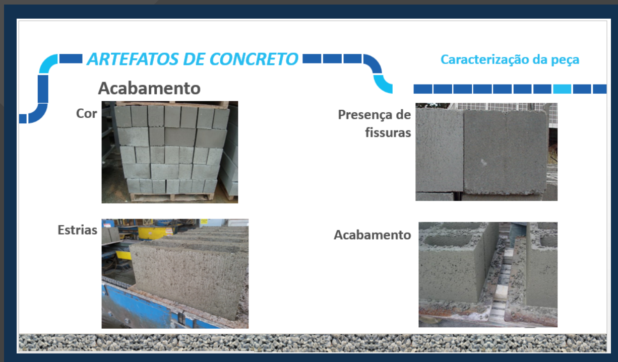
Figura 4: Inspeção visual dos blocos
